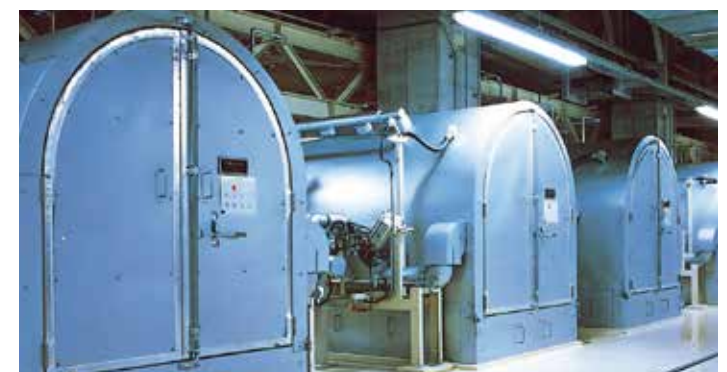
発生槽と製品回収槽
