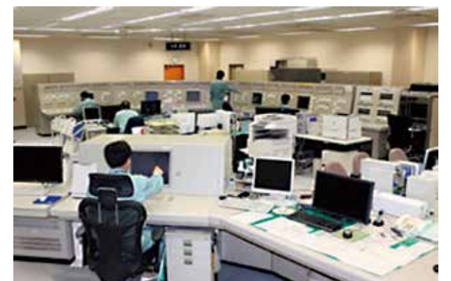
ウラン濃縮工場中央制御室
