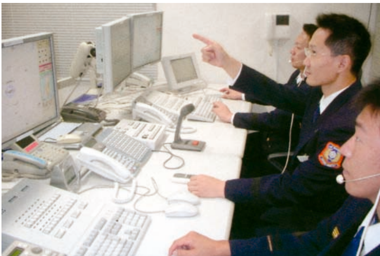
消防緊急通信指令装置
