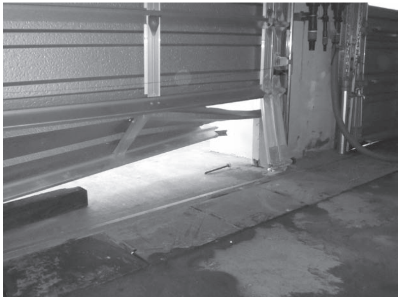
津波で被災した海水漁協荷捌所のシャッター
