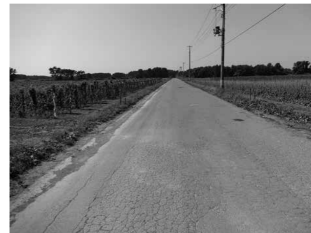
舗装の劣化が著しい倉内蒼前堂線 （第二中学校付近より撮影）
