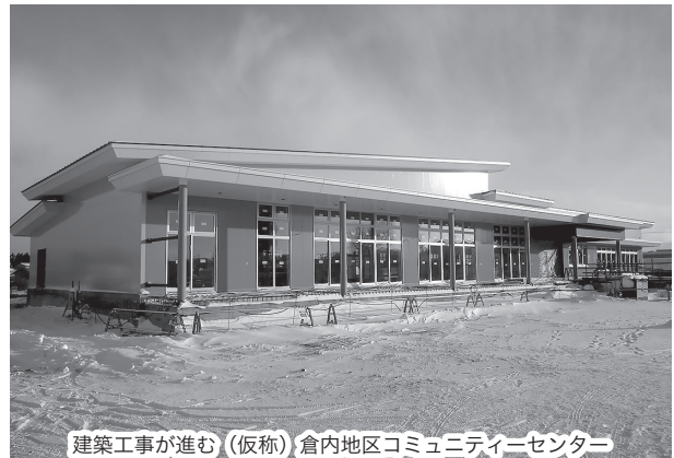
建築工事が進む(仮称)倉内地区コミュニティーセンター [30年1月現在]
