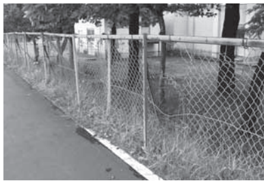
破損している校地周辺のフェンス
