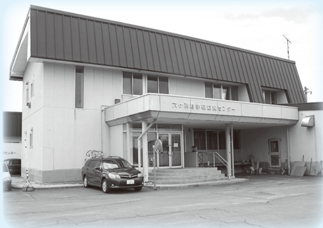
老朽化した学校給食センター
