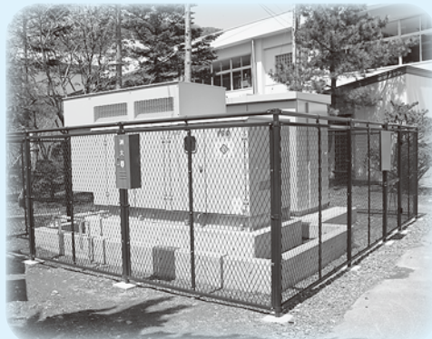
昨年整備した避難施設の非常用発電機
