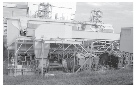
津波で破損した通風機
