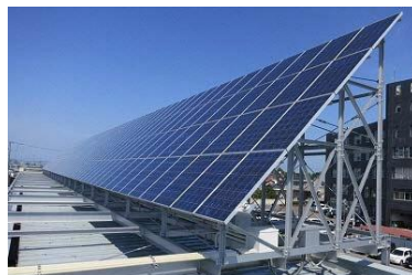
太陽光発電設備 (平川市庁舎)
