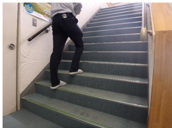
分庁舎階段（踏面が狭く登りづらい）
