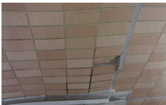
雨漏りの原因
