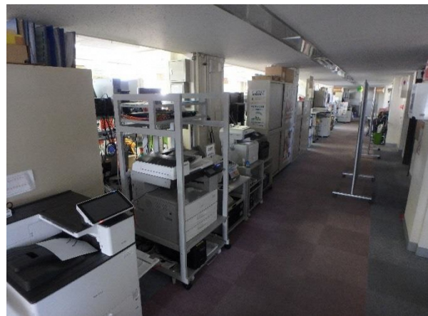
課内にスペースがなく、廊下に設置されている 防災関連機器類
