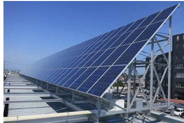
太陽光発電設備 (平川市庁舎)
