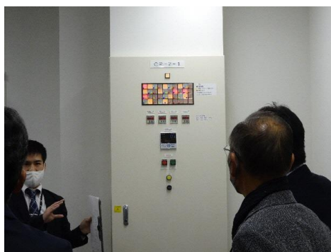
災害対策室 陽圧化装置 (女川町庁舎)
