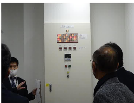
災害対策室 陽圧化装置 (女川町庁舎)
