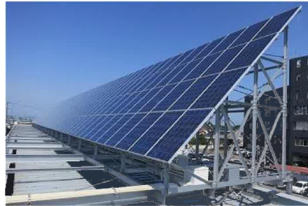
太陽光発電設備 (平川市庁舎)
