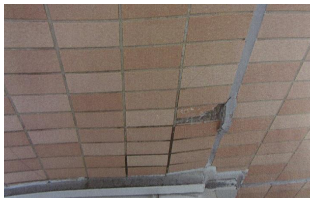
雨漏りの原因
