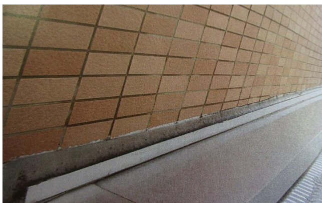
雨漏りの原因
