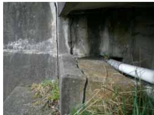
写真-9 落橋防止装置の損傷 (明神橋)
