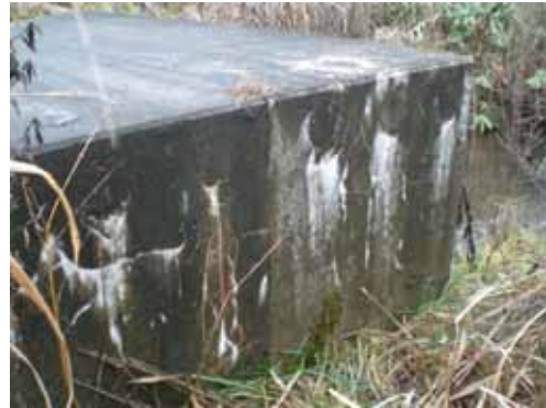
写真-7 橋台の遊離石灰 (七ツ山橋)
