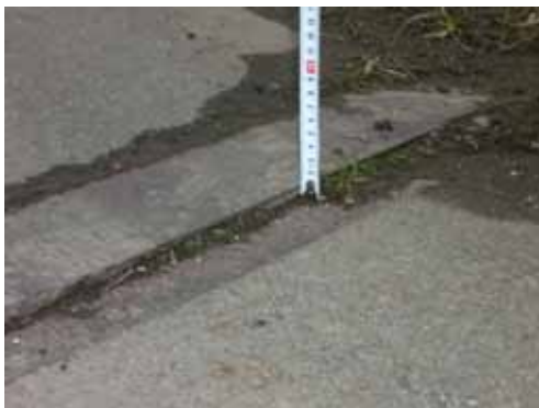
写真-8 伸縮装置の段差 (湯ノ沢橋)
