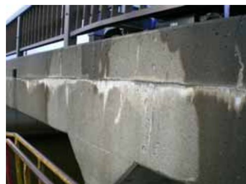
写真-11 地覆の遊離石灰 (市柳橋)
