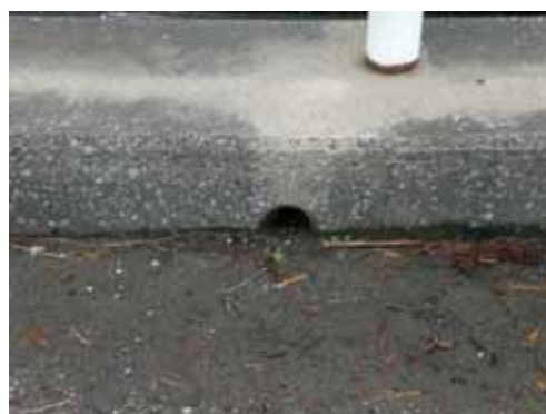
写真-10 排水管の損傷 (馬門川橋)
