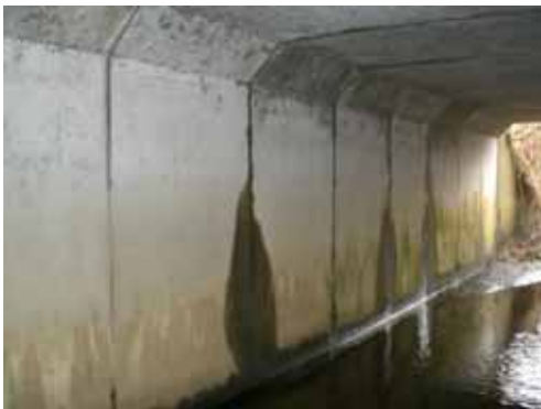
写真-6 橋台の漏水 (七ツ山橋)
